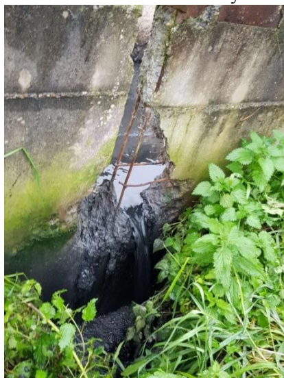
Фото 2. Прорыв иловых карт очистных сооружений г. Луга. Фото А.Зиновьев
